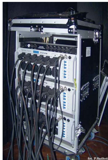
Wśród całej gamy urządzeń oświetleniowych, dostarczonych przez Przedsiębiorstwo Specjalistyczne „Teatr”, są między innymi 3 moduły dimmerów 6pack firmy Strand Lighting.
